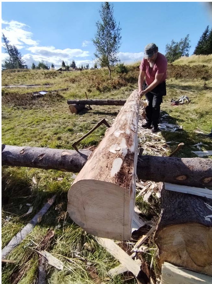
Nye stokker må til i gjenreisningen av Klevasmia, og de bearbeides med øks og bile. Her er håndverker Erlend Sommervold som leder arbeidet, og som merket tommer da smia ble demontert.
