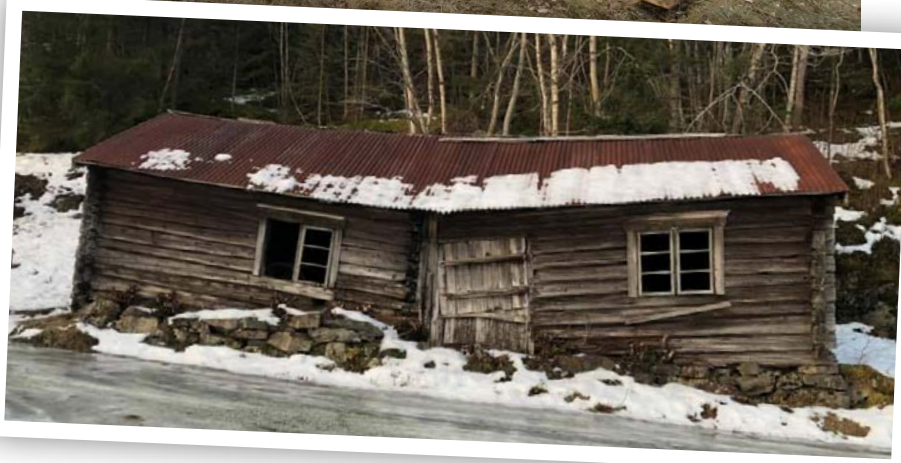
Den siste smeden ga seg på 1960-tallet. Siden har smia stått til forfall. «Klevasmias venner» demonterte smia i 2021 og sørget for trygg lagring. I samarbeid med Skogselskapet i Trøndelag blir nå Klevasmia gjenreist ved Sandholtan, ikke langt fra sin opprinnelige lokasjon i gamle Horg Herred i Melhus.
